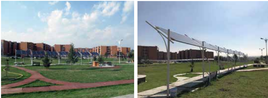
Estructuras con paneles solares que surten de energía al alumbrado de uso común en el conjunto estudiado en Puebla, Puebla
