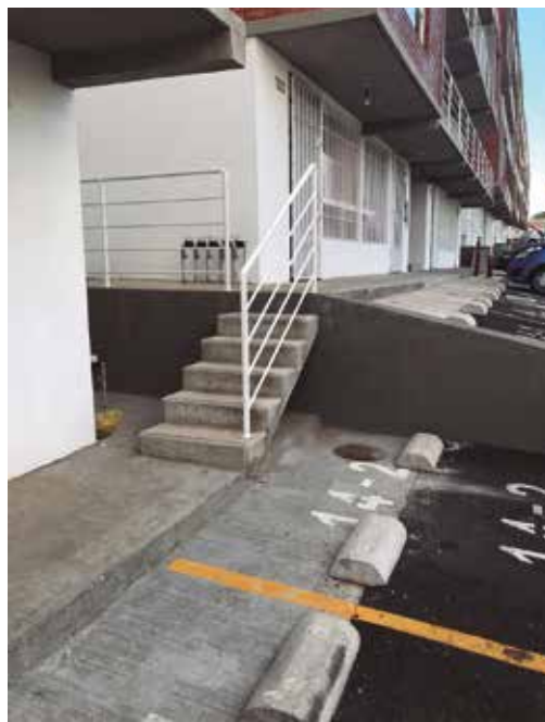
Desniveles entre banquetas y vialidades sin rampas de acceso y obstruidas por cajones de estacionamiento en el conjunto estudiado en Guadalajara, Jalisco
