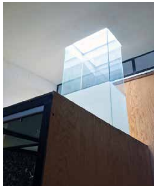
Tragaluz al interior que también funciona como ducto para ventilación del baño en vivienda modelo del conjunto estudiado en Hermosillo, Sonora
